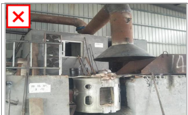
存在返钢（钢水）工艺的生产企业，平台上的操作室外墙未封闭
