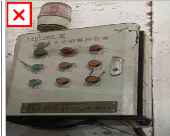
粉尘涉爆企业使用火花探测器未投用 判定为重大隐患
