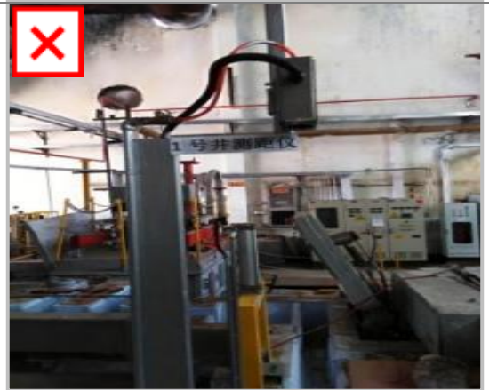
深井铸造铝液溜槽液位检测仪故障未 修复判定为重大隐患
