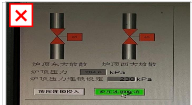
炉顶放散阀与炉顶工作压力联锁未开启
